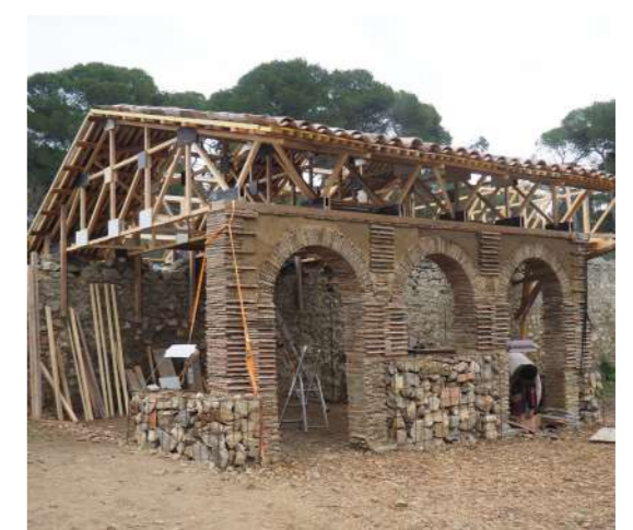
Jour de rendu final H-1, Décembre Gabarits et coffrages des arches viennent d'être déposés sous les acclamations du collectif et des premiers habitants arrivés sur site.
