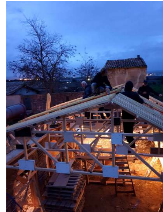
Veille de rendu final, Décembre Les phares de voiture comme éclairage, les derniers éléments de toiture sont fixés.
