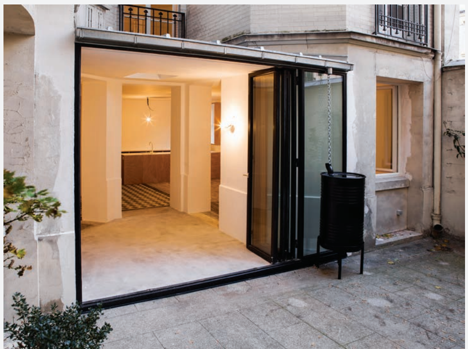
Extrait de l'album de Félix Mulle : transformation d'un local commercial en habitation et extension sur cour, Paris XVII e (architecte Atelier de l'Ourcq, paysagiste Thierry Padoan, 2014)
