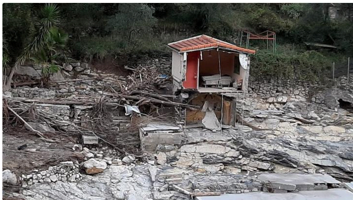
Une partie de cette maison située dans le hameau de Piene basse (Breil-sur-Roya, Alpes-Maritimes) a été emportée par la Roya lors du passage de la tempête Alex le 2 octobre 2020. ● Loïc Blache/FTV
