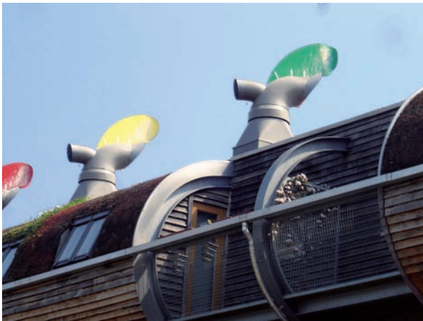
Bouche d'aération double flux, BedZed, Arch. Bill Dunster © cnoa
